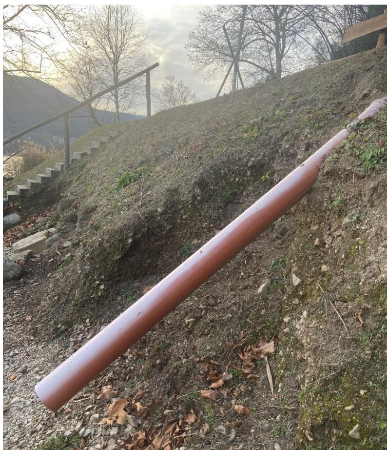
Figura 13: Fotografia di uno dei tubi affiorati in superficie.
