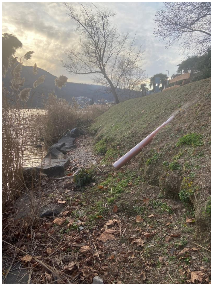
Figura 14: Fotografia del piede della scarpata eroso e di uno dei tubi affiorati in superficie.
