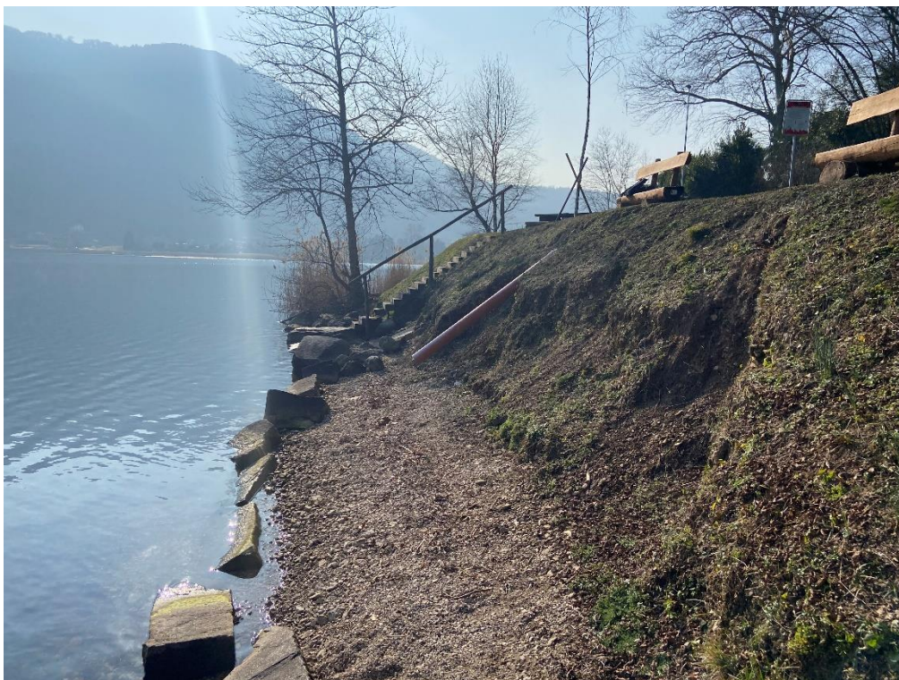
Figura 12: Fotografia della scarpata erosa e di uno dei tubi affiorati in superficie.
