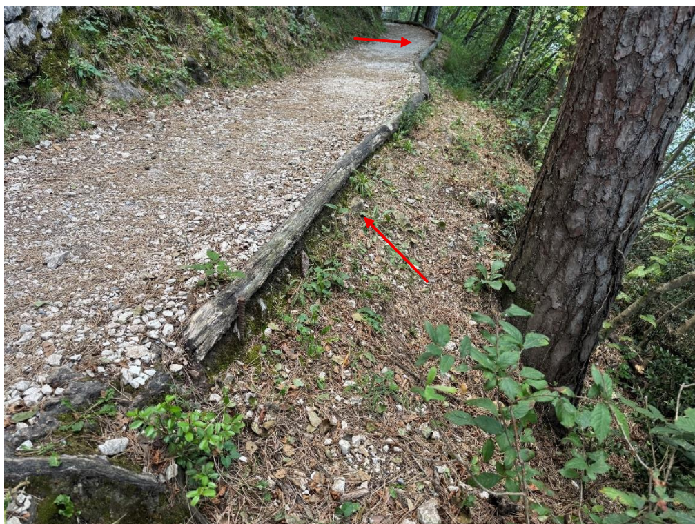
Figura 4: In alcuni casi la sostituzione con pali doppi non è urgente ma dovrà essere fatta nei prossimi anni (ca. 2-5 anni). In caso di intervento si può valutare caso per caso se sostituirli nell'immediato.
