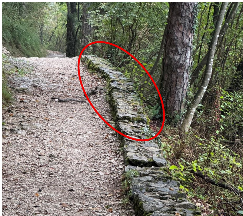
Figura 6: Rifacimento muro non urgente (RiM2), Rifacimento muro non obbligatorio, circa 7.5 m x 80 cm.
