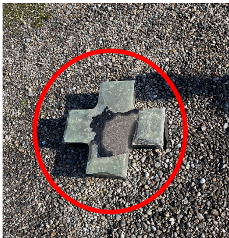
Elementi in lattoneria danneggiati
