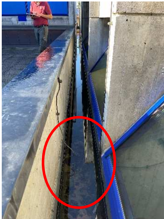
Mancato rispetto delle regole di deflusso delle acque
