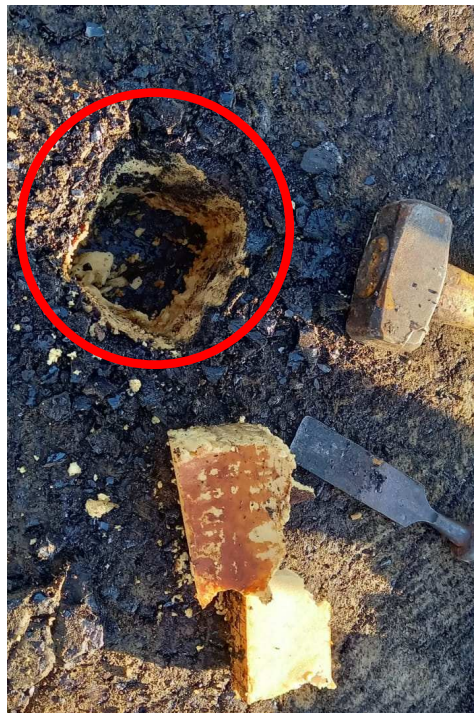
Isolante termico con presenza di umidità
