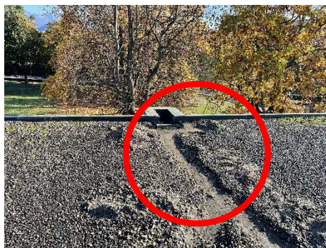
deterioramento dei materiali utilizzati
