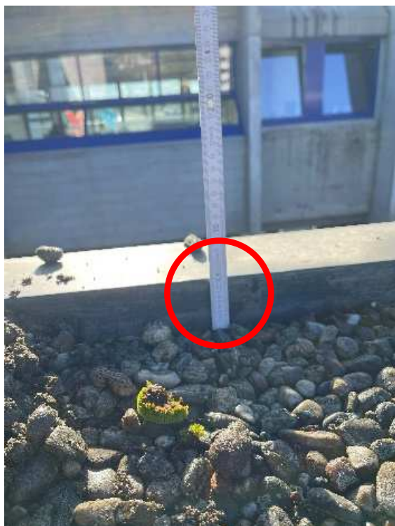
Mancato rispetto della quota di sicurezza
